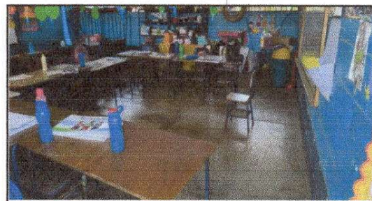
FOTO 6: Sustrucción de piso cerámico
